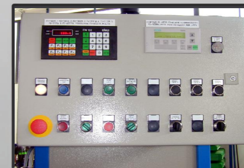
Pannello di controllo
